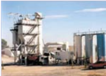
Fig. 0.3. Planta de fabricación de mezcla bituminosa en caliente de tipo discontinuo.
