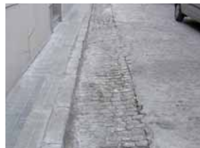
Nº 5: Detalle de fallo de firme por asentamiento en capa de base de adoquín y falta de zona de solape.
