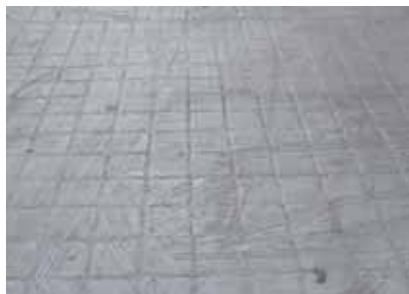
Nº 6: Detalle de reposición baldosa de mortero de cemento, con excesiva lechada de mortero.
