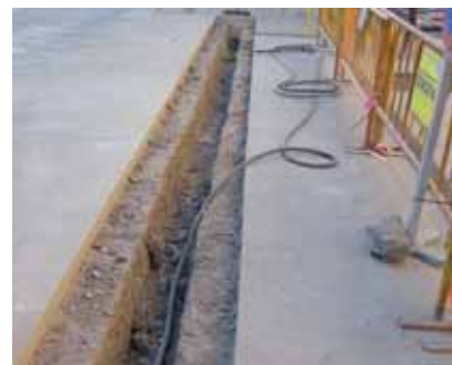
Nº 1: Canalización de gas. Detalle de solape sólo realizado en capa de rodadura.
